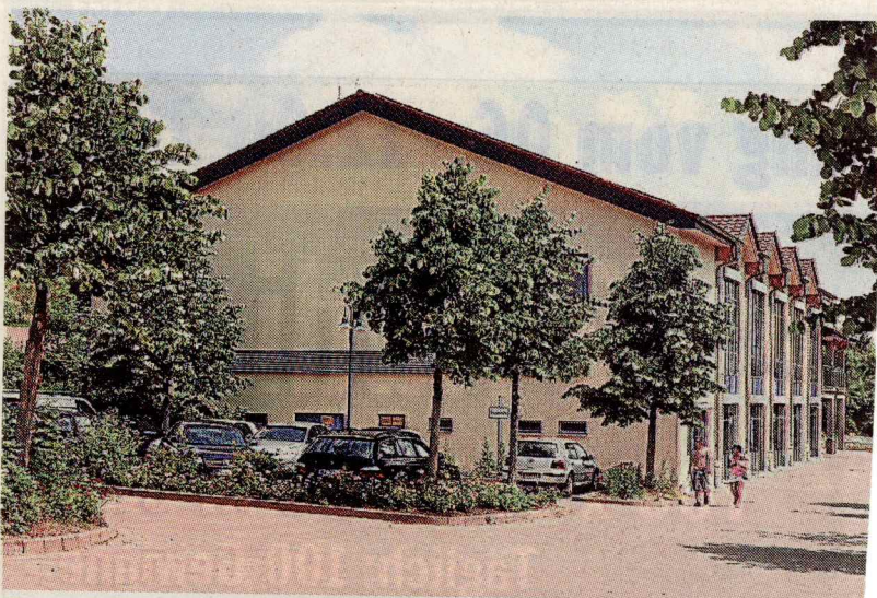
In der Nackenheimer Gemeindehalle tropft es durchs Dach.
